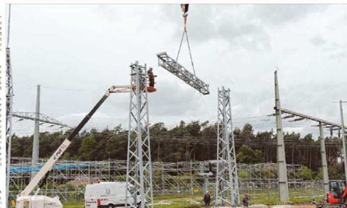
Mit einem Autokran wurde das Freileitungsgatter, die Anbindung des Umspannwerks an die Hochspannungsleitung, eingehoben und installiert. F. T. Schaller
